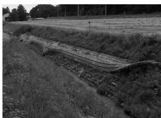
写真-2 施設被害状況(令和4年7月)
