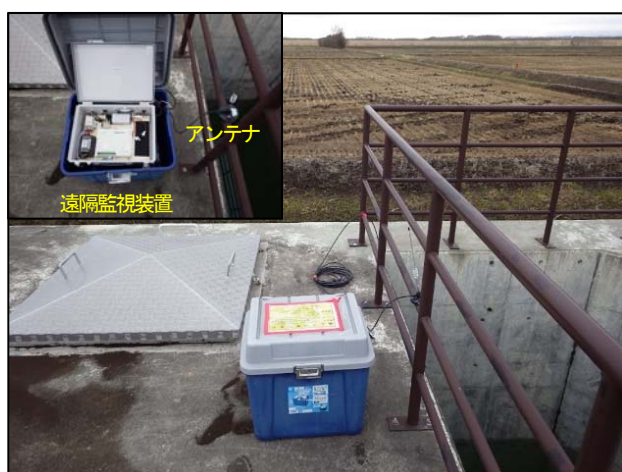
写真-4 遠隔監視装置と監視アプリ
