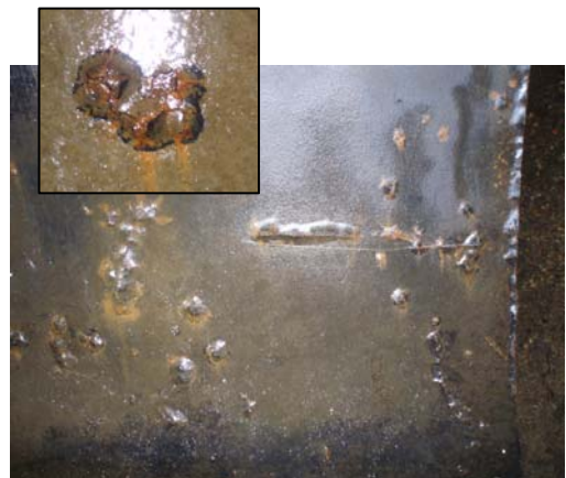
写真-14 鋼製管の側面の腐食
