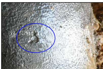
写真-3 ダクタイル鋳鉄管(短管)の孔食
