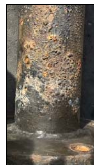
写真-6 塗装劣化と赤錆
