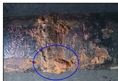
写真-7 溶接部の腐食(こぶ状)
