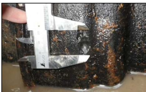
写真-4 ソケット継手部の腐食
