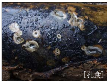
写真-2 被覆下の腐食状況
