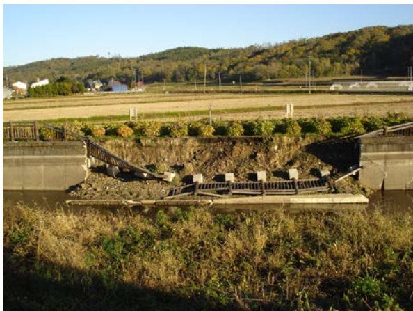
▲北海幹線用水路の擁壁倒壊地点(赤平)
