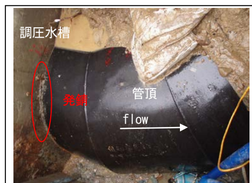
写真-2 管外面の状況
