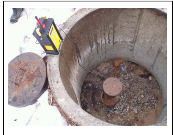
写真-2 センサーの設置状況(空気弁工)
