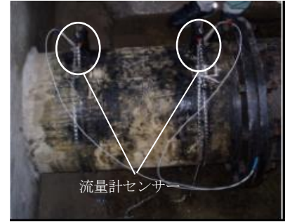
写真-2 流量計取付状況
