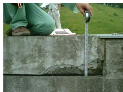
写真-2 PCスラブ(沼尻第1FP)の劣化状況
