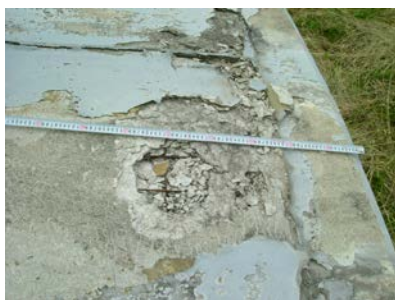
写真-1 PCタンク構造(姫川第1FP)の劣化状況
