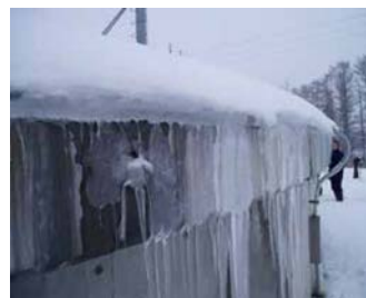
写真-3 姫川第1ファームポンドの凍結状況 (文献 3) から引用)
