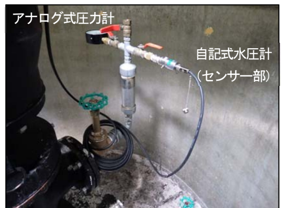
写真-3 自記式水圧計の設置事例
