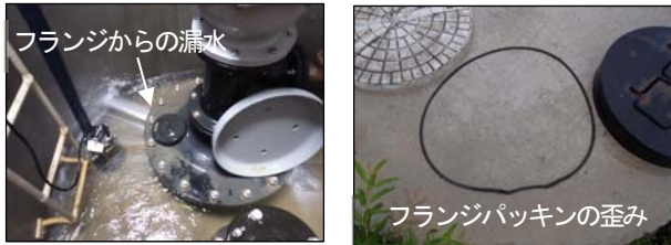
写真-2 空気弁工の漏水事例
