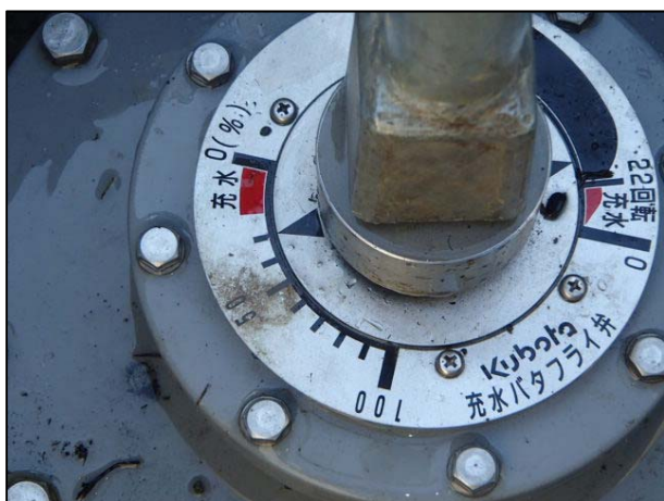
写真-1 管路途中の制水弁の中間開度設定の事例 (水張り作業時、流量制御は別地点)
