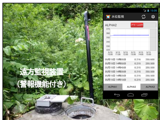
写真-4 遠方監視装置の使用事例
